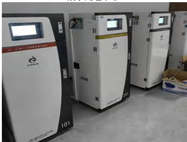
废水在线监测系统
