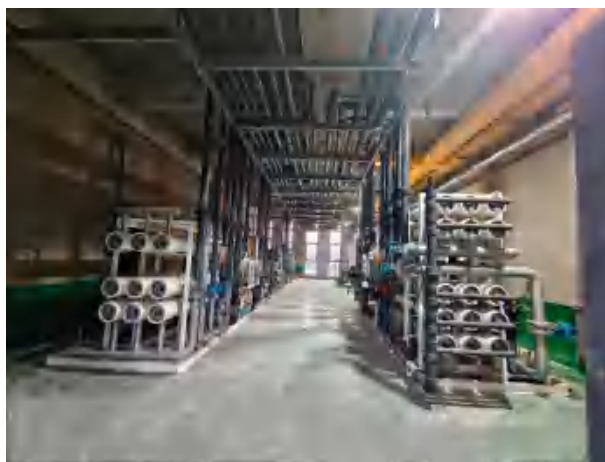
废水处理设施
