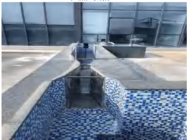
废水排放口在线监测探头
